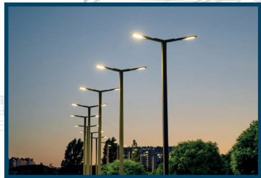
Illuminazione esterna / Outdoor lighting
