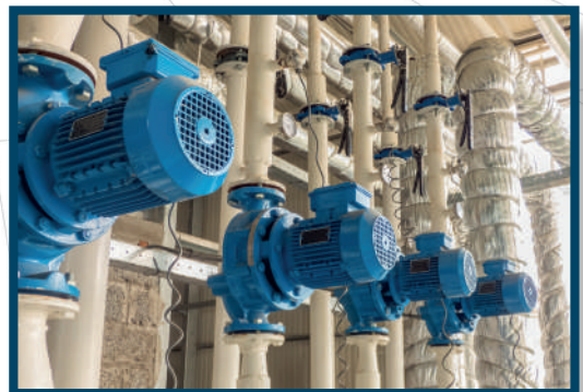
Movimentazione fluidi / Fluid pumping
